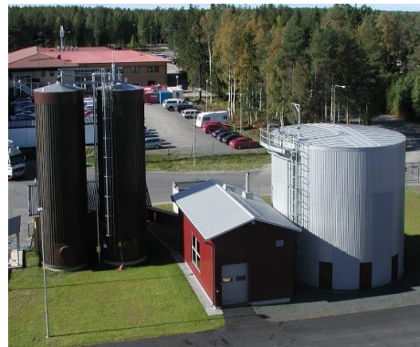
Die biologische Abwasserbehandlungsanlage bei Norrmejerier in Schweden
